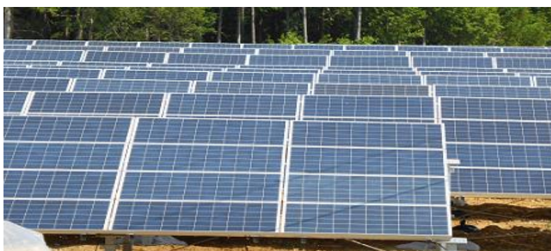
① 自社発電所 【高圧 300Kw】
